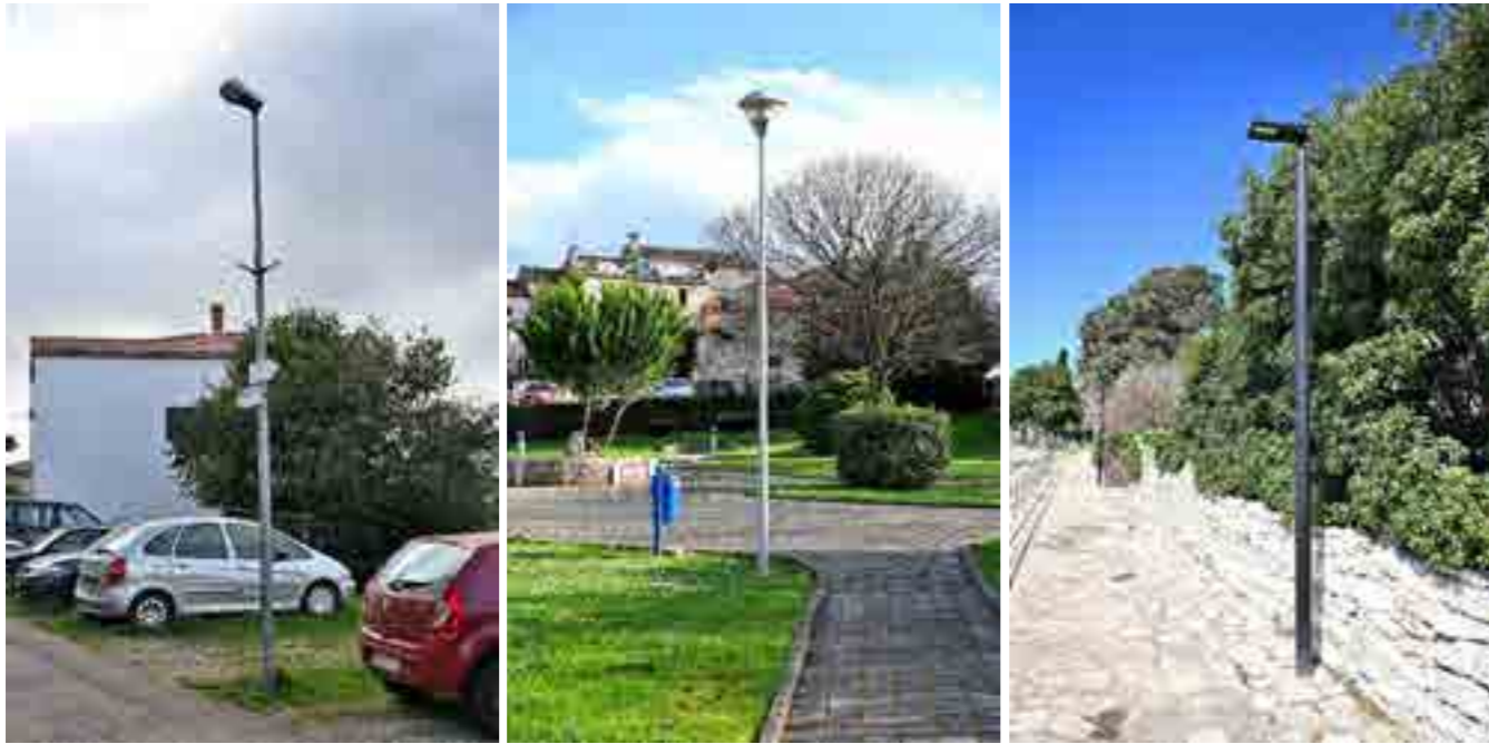
Sl. 91. Različiti oblici rasvjete na području Općine Brtonigle–Verteneglio: preostali dijelovi konvencionalne rasvjete (lijevo), dekorativna rasvjeta u sjevernom parku u Brtonigli (sredina), suvremena rasvjeta bazirana na LED tehnologiji (desno)
